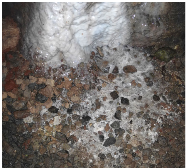
Abb. 16: Kalkumkrusteter Schotter im abfließenden Wasser am Stollenrand. Bildbreite ca. 40 cm.
